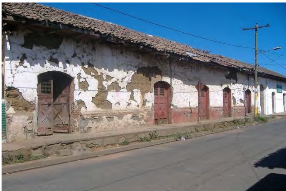
Casa de don Félix Azcárate y su esposa doña Josefana Obregón; en donde funcionó el Hotel Universal, conocido como Hotel Azcárate. Foto captada por Francisco-Ernesto Martínez, en 2008.
